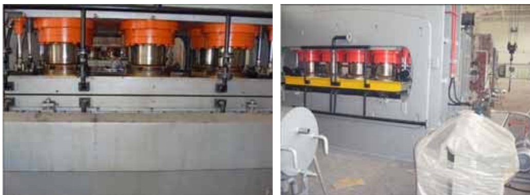
Рис. 6.41. Оборудование для ламинирования ДСП с автоматической системой контроля температуры (окончание)
