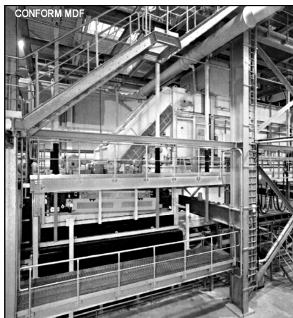
Рис. 7.21. Общий вид установки для формирования волокнистого ковра в производстве MDF (иллюстрация предоставлена фирмой Dieffenbacher)
