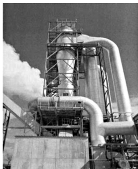
Сепаратор стружки в сушильной установке Büttner на заводе OSB в Германии
