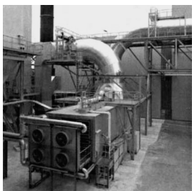
Отопительная установка к сушилке Büttner на заводе MDF во Франции
