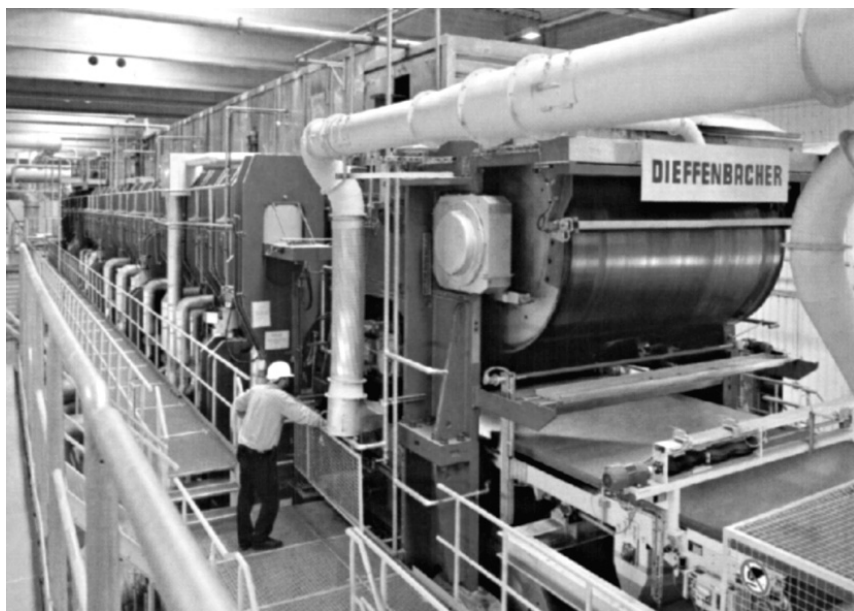
Горячая прессовая установка CPS, используемая в непрерывном производстве древесностружечных плит
